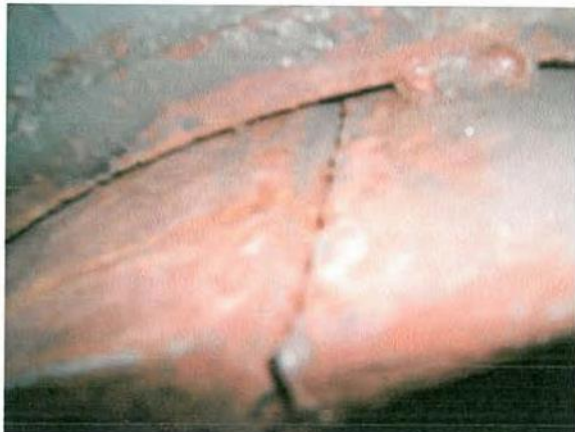
Слика 6.23 Непривар код обода ревизионог отвора [71]
