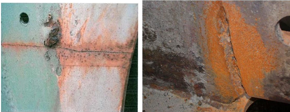
Слика 5.3 Прслине на стубу багера SchRs 800 откривене визуелним прегледом [71]
