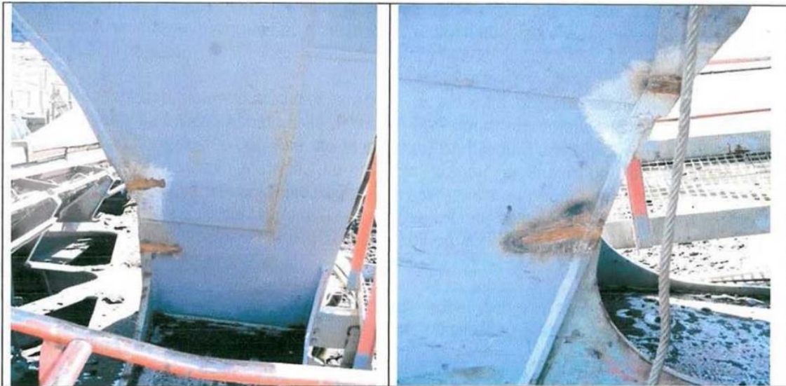
Слика 6.18 Прслине на десном делу челичне конструкције “П” носача багера [71]
