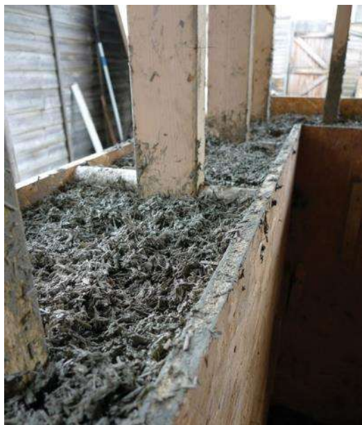
Слика 2.10: In situ зид од бетона од конопље и креча у изградњи (Stanwix 2013)
