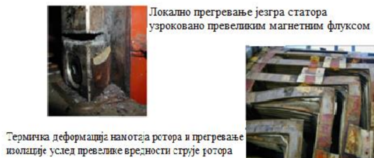
Слика 3.20: Оштећења статора и ротора турбогенератора услед повећаних термичких напрезања, преузето из [83]
