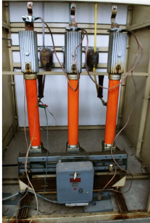
Slika 8.1 35 kV prekidač pripremljen za postupak merenja padova napona
