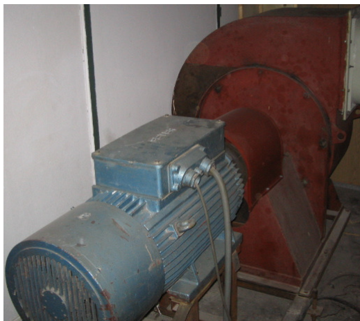
Слика 5.3. Електромотор произвођача „Раде Кончар“, модел ОН 137 и вентилатора произвођача „Термоелектро“, модел К4С – 50
