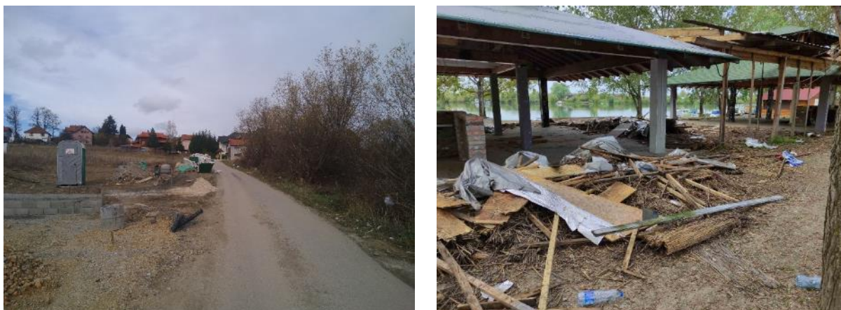
Slike 3 i 4: nemaran stav prema okruženju gradilišta Zlatibor i Sremska Mitrovica
