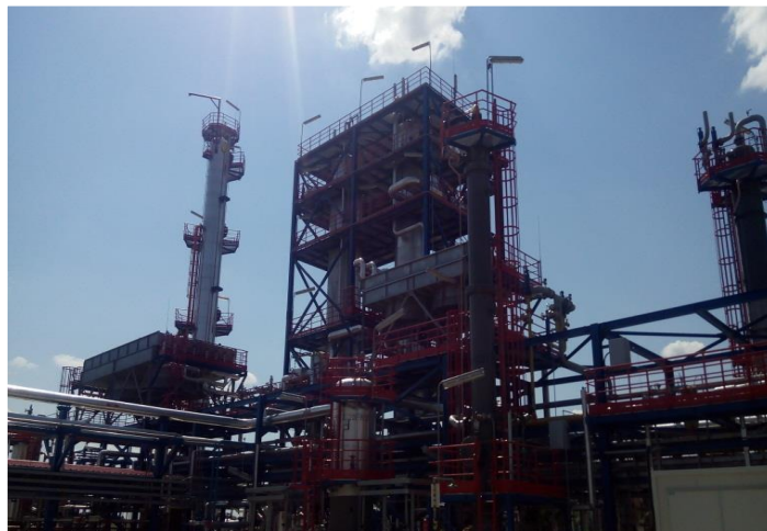
Slika 14. Aminsko postrojenje u Elemiru za uklanjanje CO 2 iz gasa
