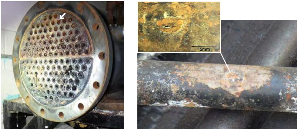
Slika 33. Stanje hladnjaka sa uočljivom korozijom koja je smanjila propisane dimenzije rashladnih otvora i ruptura cevi od oko 1 mm kroz koju je isticao amonijak [22]
