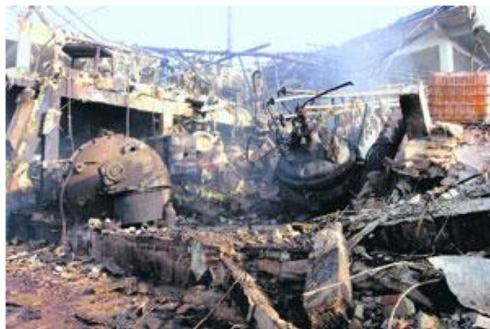
Slika 28. Ostaci postrojenja fabrike u Ahmedabad posle akcidenta 2010. godine [15]
