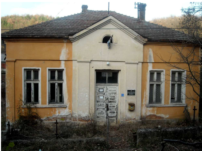
Слика 32. Напуштена зграда Месне канцеларије у насељу Прлита (Фото М. Велојић)
