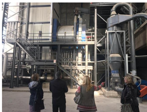
Slika 19 - Kotlovsko postrojenje na biomasi, kapaciteta 18MW u kompaniji TETO
