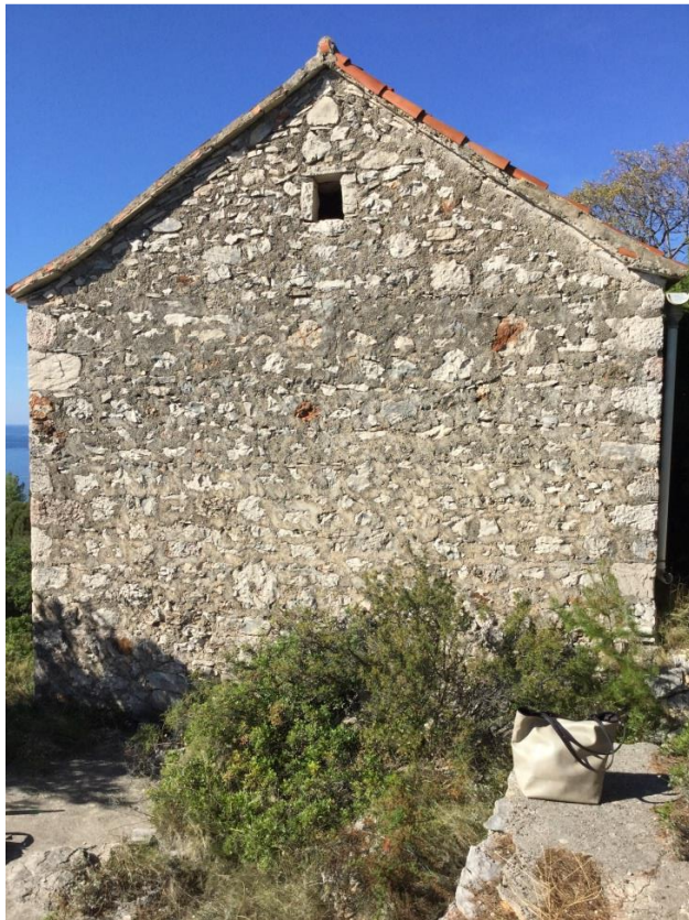
слика 29: Источна фасада –забатни зид, отовр за проветравање тавана
