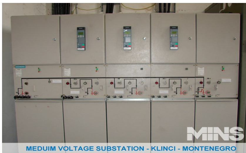
Slika 23. Transformatorska stanica SN/SN
