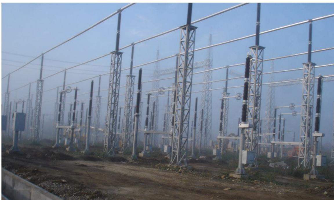
Slika 22. Razvodna transformatorska stanica 110/x kV
