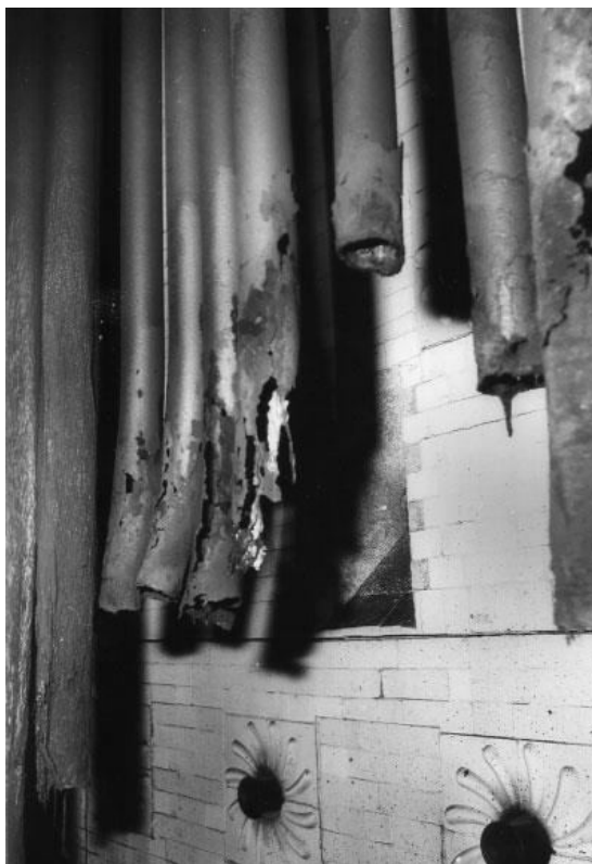
Slika 3.3.10. Oštećenje cevi izazvano pregrevanjem (12)
