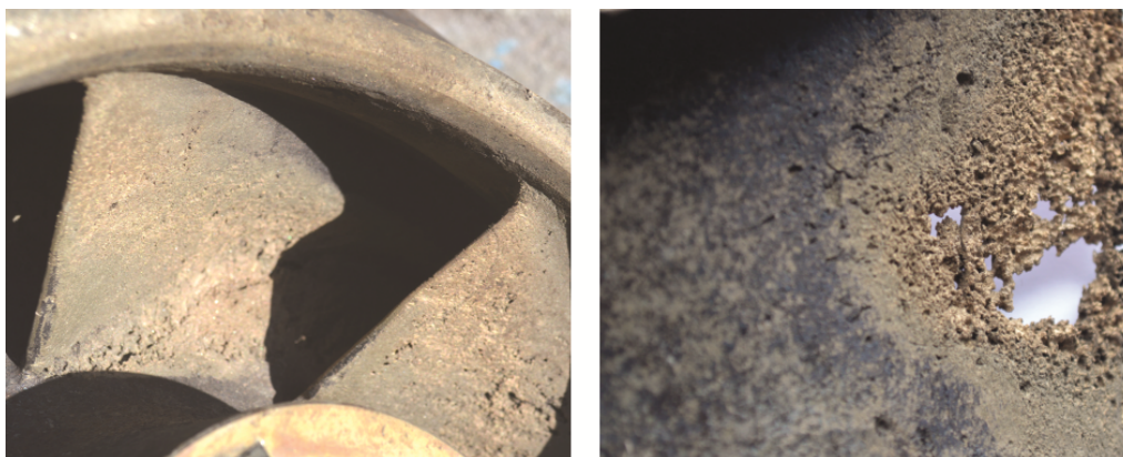
Слика 2.21. Кавитацијска оштећења на леђној (лево) и грудној (десно) страни лопатица Радно коло једне двострујне пумпе уграђене у ПС „Лиман“ (ЈКП „Водовод и канализација“ Нови Сад)
