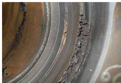
Слика 2.6. Тешко оштећено седиште једног регулационог вентила као последица кавитацијске ерозије.
