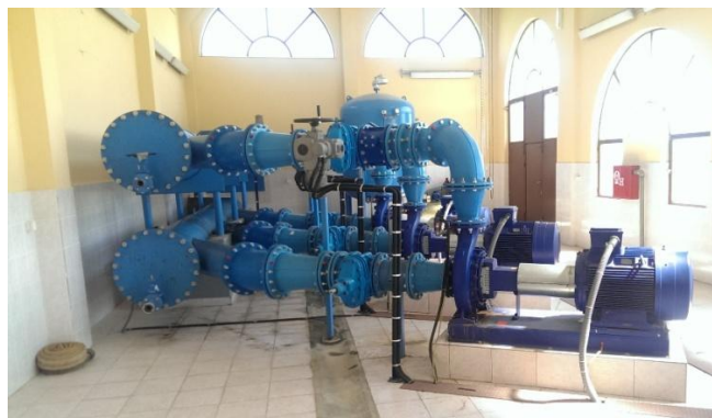
Слика 4.4. ПС „Институт“ у Новом Саду
