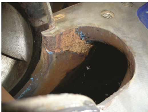
Слика 2.24. Зачетак кавитацијских оштећења у усисном каналу Двострујна пумпа типа уграђена у ПС „Штранд“ (ЈКП „Водовод и канализација“ Нови Сад)
