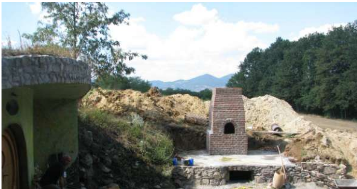
Сл.322. Објекат на ситуацији означен као објекат бр.2 Кујна - пушница током изградње 2014.
