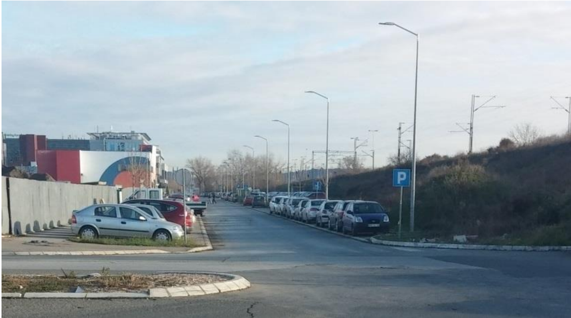
Slika 49. Testna instalacija u Ul. Milutina Milankovića posmatrana od raskrsnice sa Bulevarom umetnosti (slikano iz pravca ormana JO na čošku) u pravcu Hotela „Holiday Inn“ – u prvom planu vide se LED svetiljke VOLTANA 3
