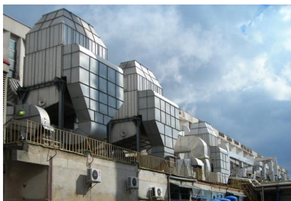
Слика 17. Рекуператори топлоте
