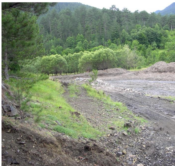
Сл. 17. Заплав консолидационе преграде на реци Тари (Институт за водопривреду "Јарослав Черни" и Енергопројект - Хидроинжењеринг, 2006)
