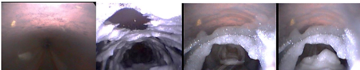
Slika 70. Unutrašnja površina cevi u sistemu za ispitivanje korozije u uslovima kondenzacije snimljena boroskopom pre i nakon ubrizgavanja pene.
