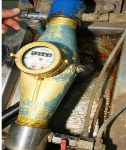
Слика. 7.20 Мерење протока течности за хлађење помоћу индустријских водомера[115,117]
