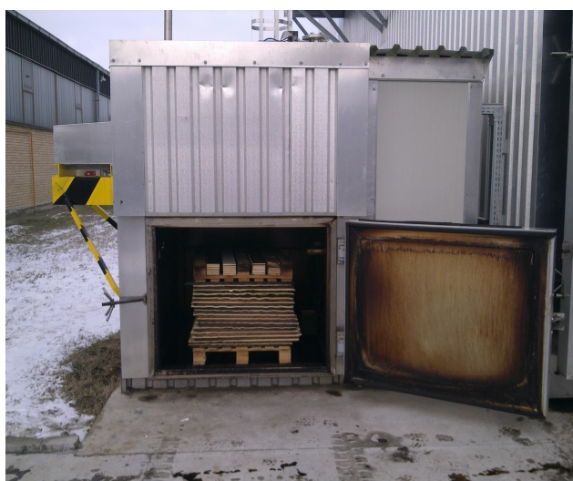
Slika 22. Laboratorijska komora za termički tretman (Tarkett doo – Bačka Palanka)
