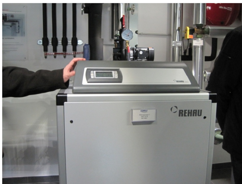
Slika 212. Toplotna pumpa (foto: A. Vranješ)
