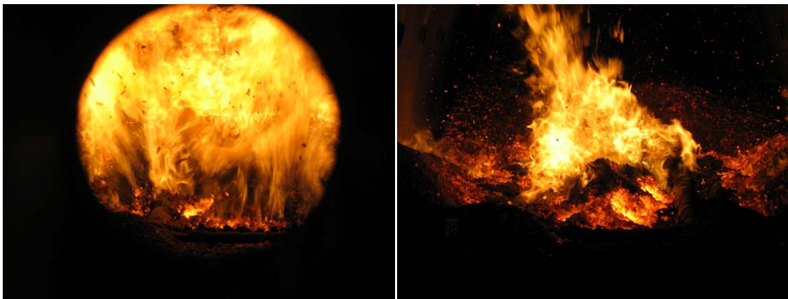
Слика 57. Сагоревање пелета у котлу – поглед кроз контролни отвор/кроз врата ложишта
