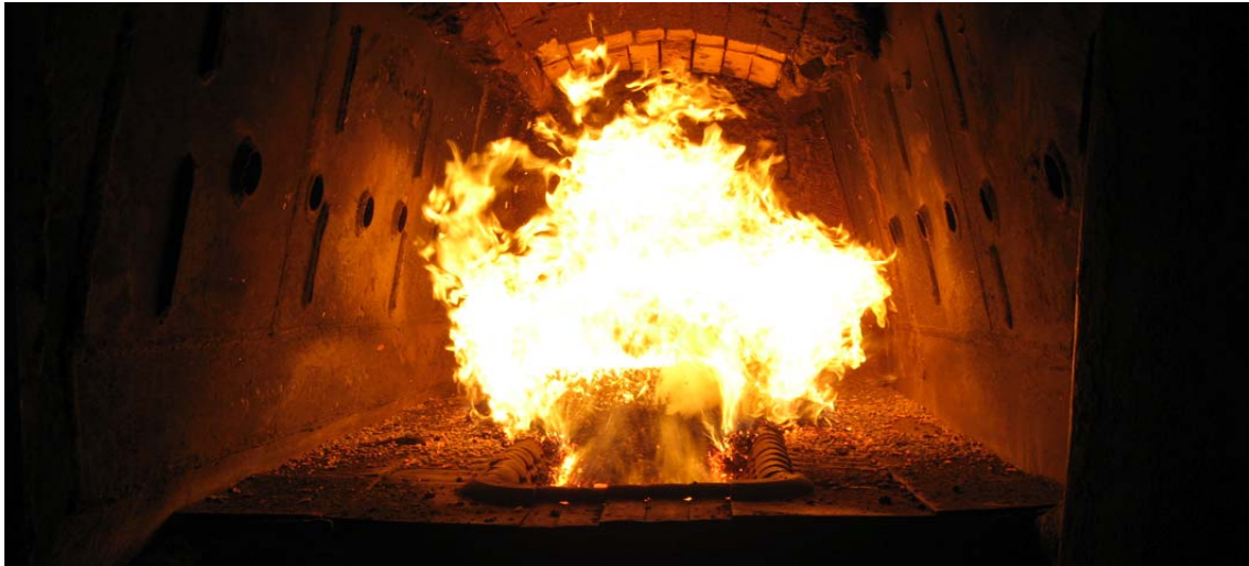
Слика 81. Сагоревање пелета у ложишту котла - поглед кроз отворена врата ложишта
