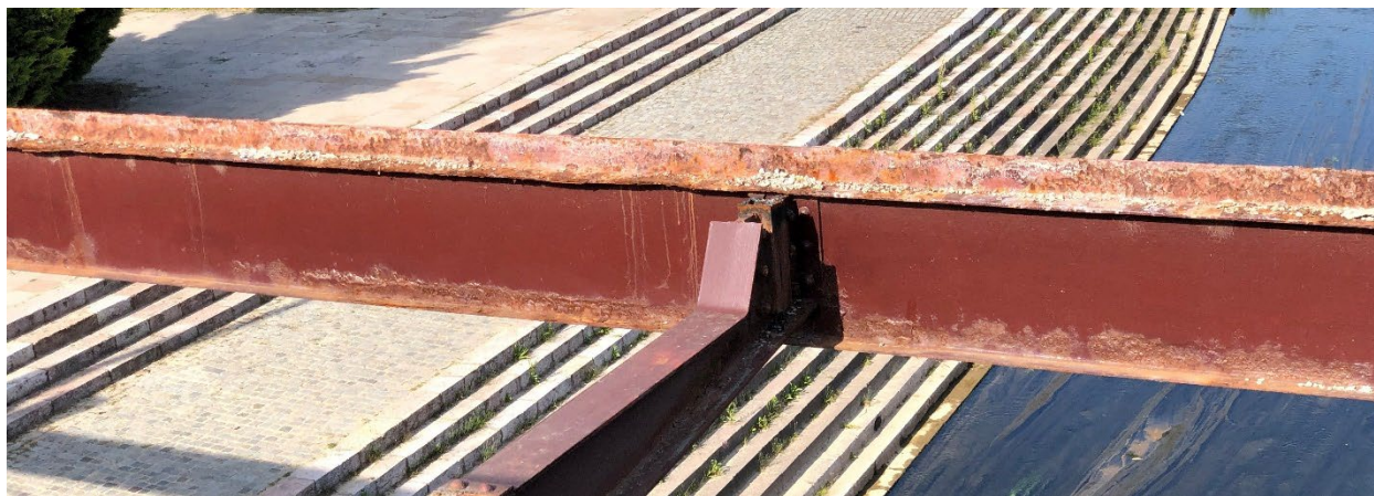
Slika 40 - Opšta korozija na glavnom nosaču mosta preko reke Nišave na ulazu u nišku tvrđavu
