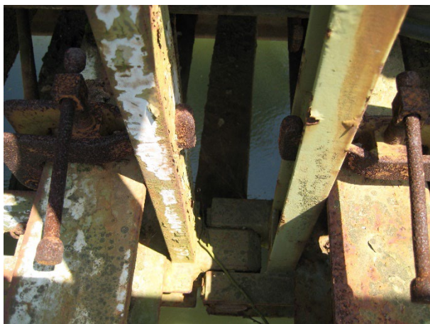
Slika 41 - Galvanska korozija na delovima mosta preko reke Mlave na putu za manastir Rukumija
