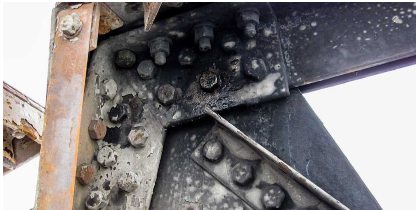
Slika 50 - Izgled veze čeličnih elemenata nakon požara
