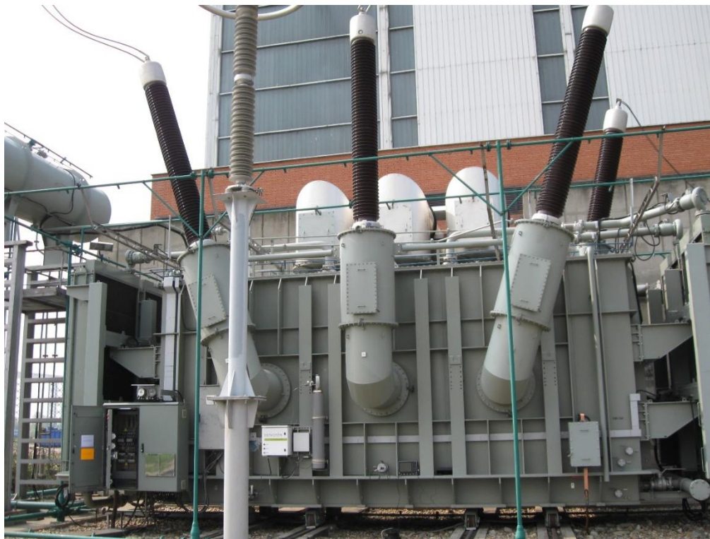
Слика 2.11 – Блок трансформатор назначене снаге 725 MVA у Термоелектрани „Никола Тесла Б“ у Обреновцу на коме је извршен оглед надзирања сигнала парцијалних пражњења помоћу UHF давача у облику сонде уграђене кроз пропусни уљни вентил. Оглед је вршен при раду енергетског трансформатора у погону.
