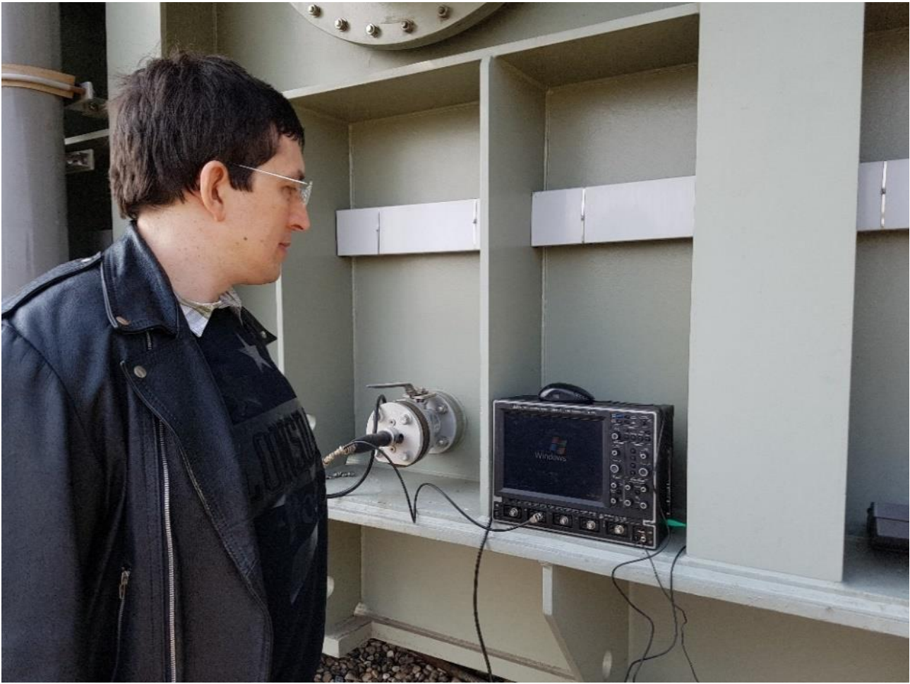
Слика 2.15 – Извођење огледа привременог надзирања парцијалних пражњења помоћу UHF једнополног давача у енергетском трансформатору у погону у Термоелектрани „Никола Тесла Б“ у Обреновцу.
