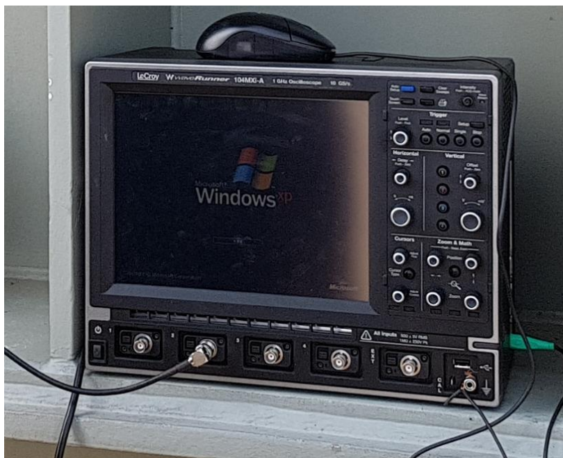
Слика 2.17 – Дигитални осцилоскоп коришћен у огледу за привремено надзирање парцијалних пражњења при раду енергетског трансформатора у погону.
