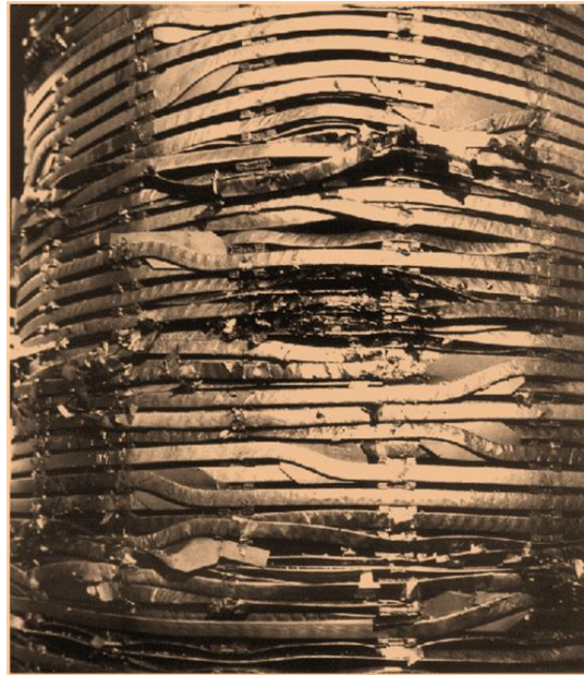
Слика Б.5 – Оштећење намотаја трансформатора услед кратког споја (7) .
