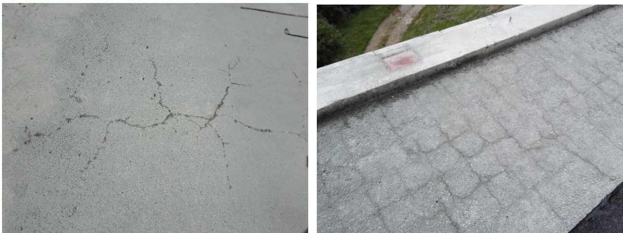
Slika 2.9 Prsline usled plastičnog skupljanja (levo) i plastičnog sleganja (desno)
