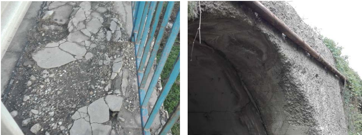
Slika 3.2 Oštećenja betona usled dejstva mraza
