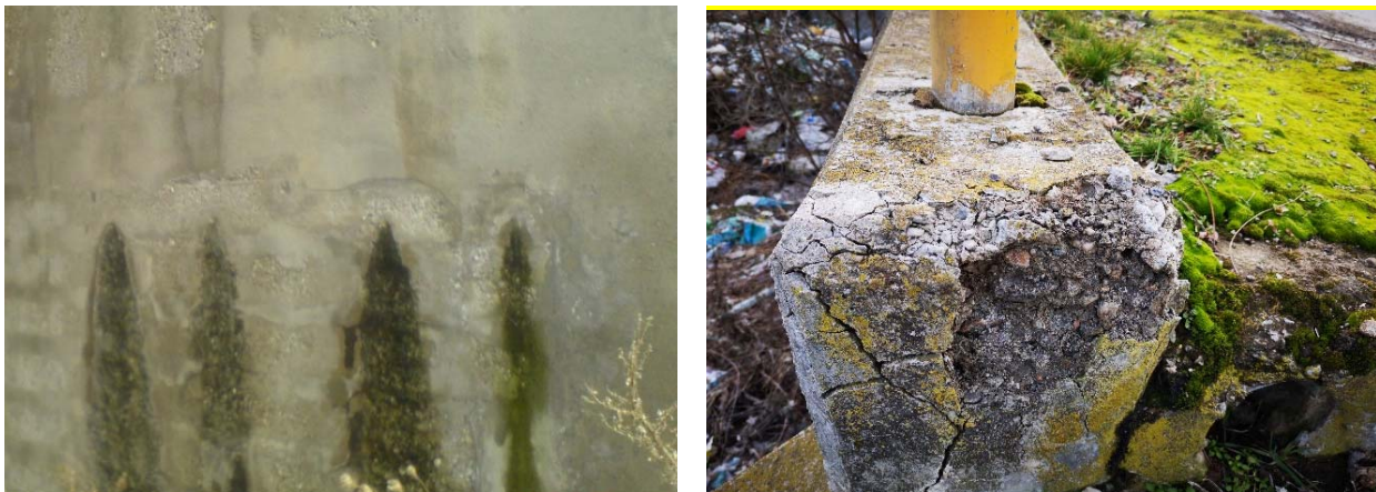
Slika 3.16 Mahovina na betonskim elementima mosta
