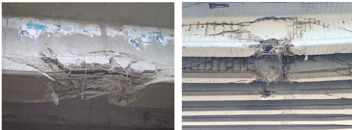
Slika 3.5 Oštećenja nastala udarom vozila
