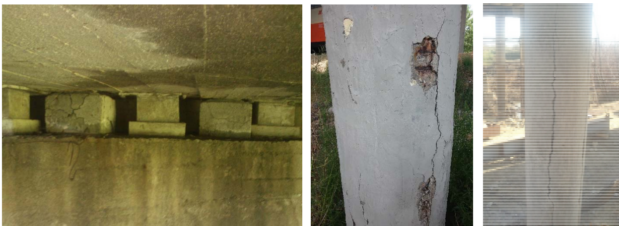
Slika 3.7 Oštećenja mostova usled preopterećenja
