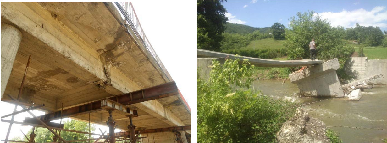
Slika 3.22 Oštećenja mostova usled hazardnog dejstva poplava
