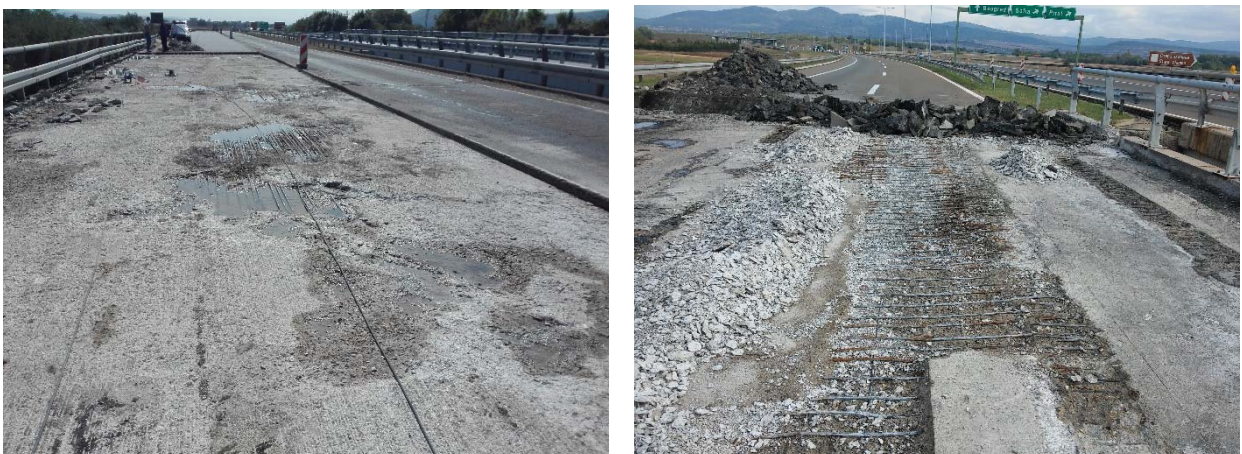
Slika 3.19 Oštećenje beton kolovozne ploče ispod hidroizolacije
