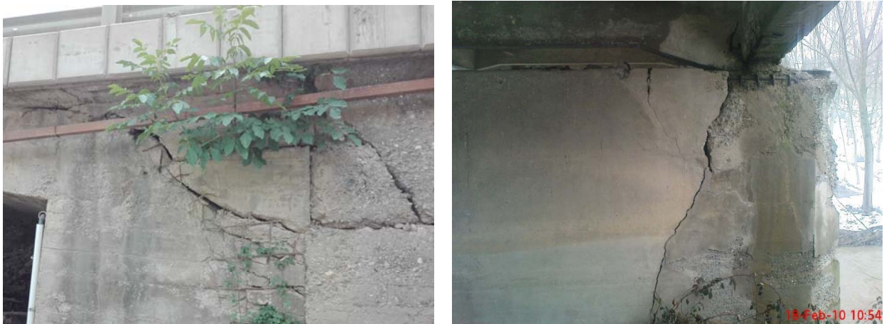
Slika 3.4 Oštećenja potpornih elemenata mostova usled sleganja
