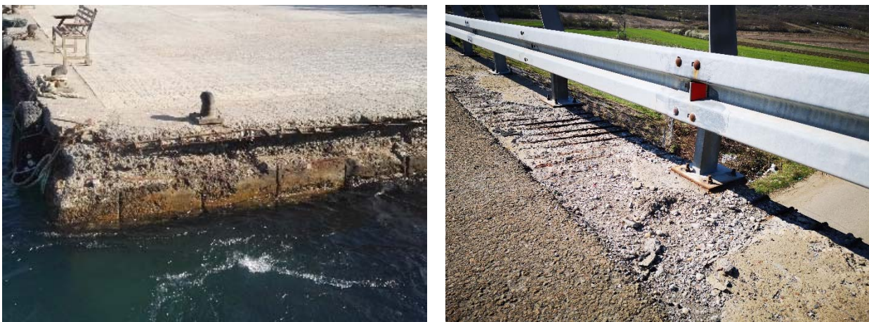
Slika 3.12 Oštećenja betona izazvana hloridima
