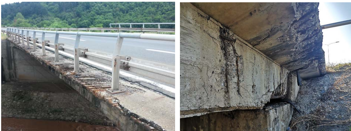
Slika 3.20 Oštećenja mostova usled slivanja vode
