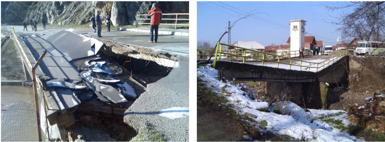
Slika 3.9 Oštećenja mostova usled poplava
