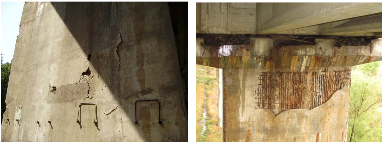
Slika 3.13 Oštećenja usled korozije armature
