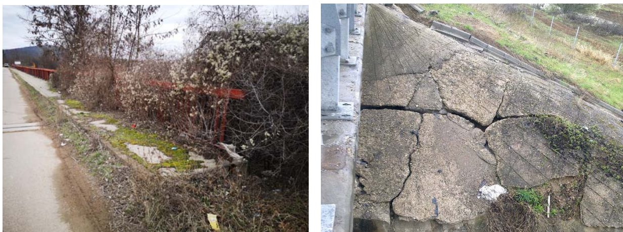
Slika 3.15 Oštećenje betona usled dejstva vegetacije
