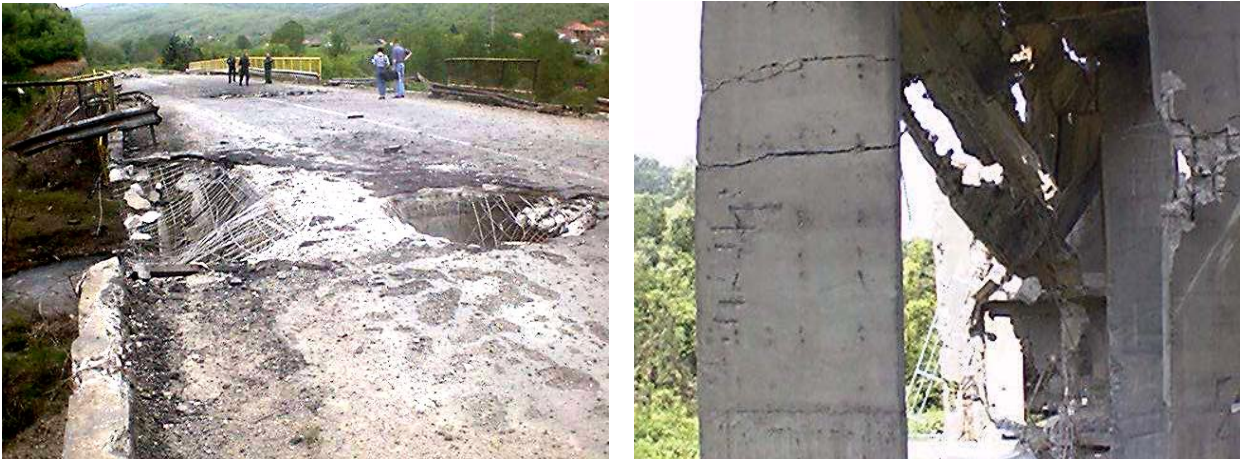
Slika 3.6 Oštećenja armirano betonskih mostova usled eksplozija
