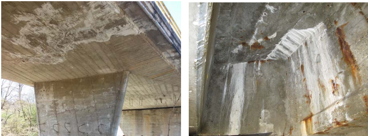
Slika 3.10 Karbonatizacija na betonskim elementima mosta
