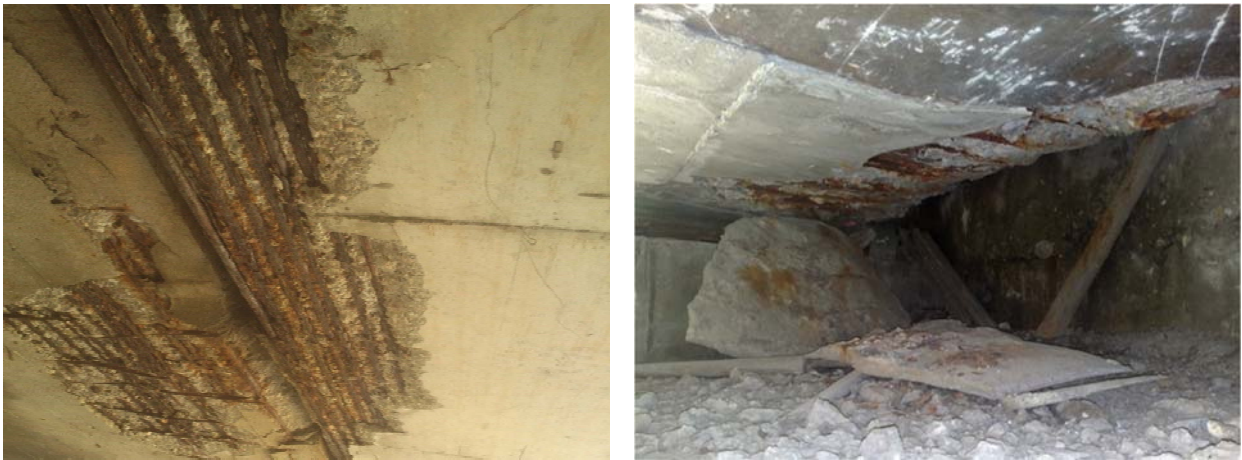
Slika 3.18 Oštećenja betona u zoni ispod dilatacija
