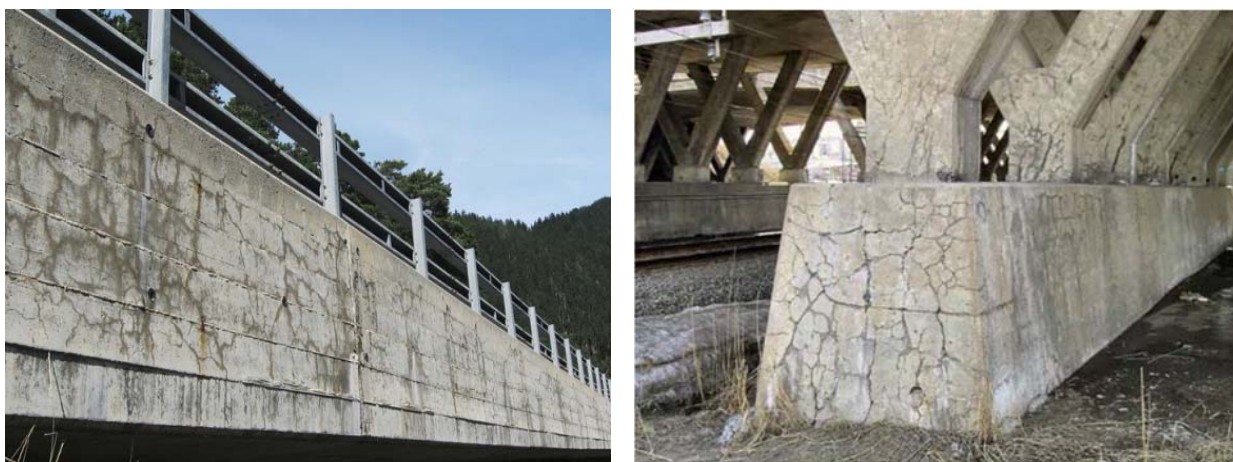
Slika 3.14 Oštećenja betona usled alkalno-agregatne reakcije [79]
