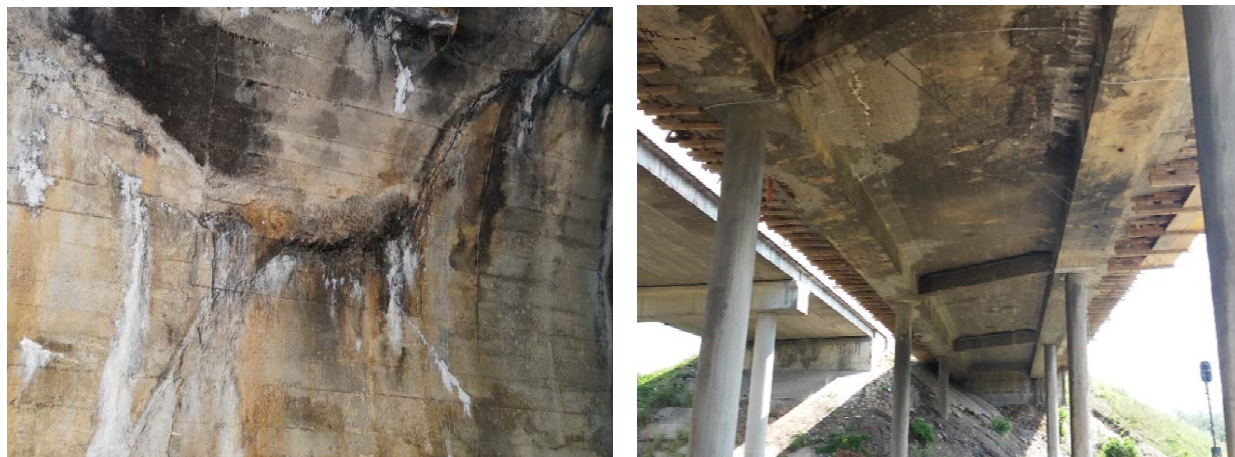
Slika 3.11 Oštećenje betona usled dejstva sulfata
