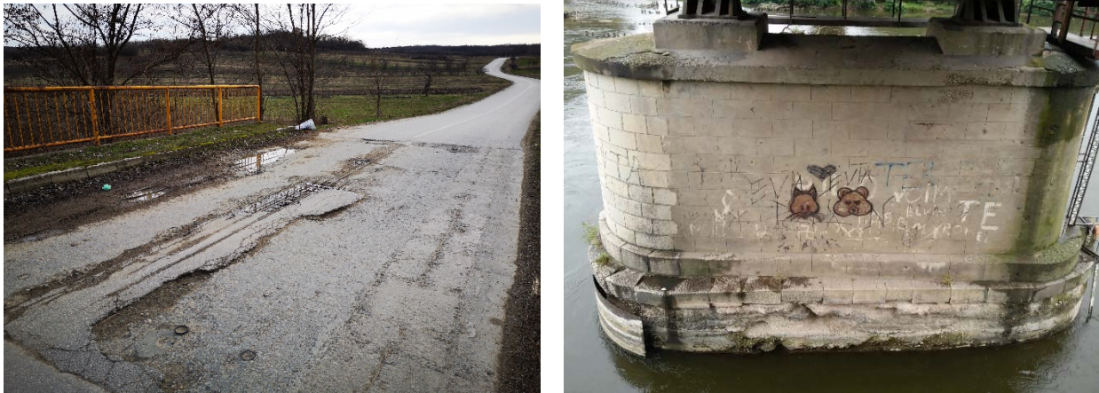
Slika 3.3 Oštećenja betona usled erozije betona
