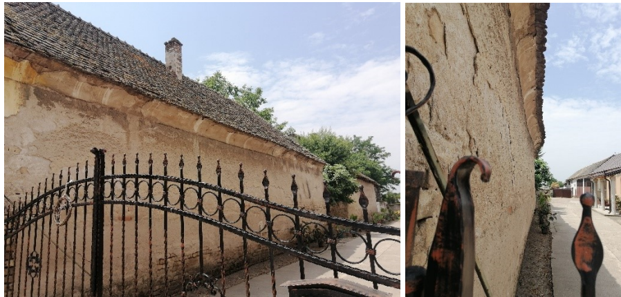
Slika 207 i 208: Današnje stanje predmetnog zida od čerpića 419
