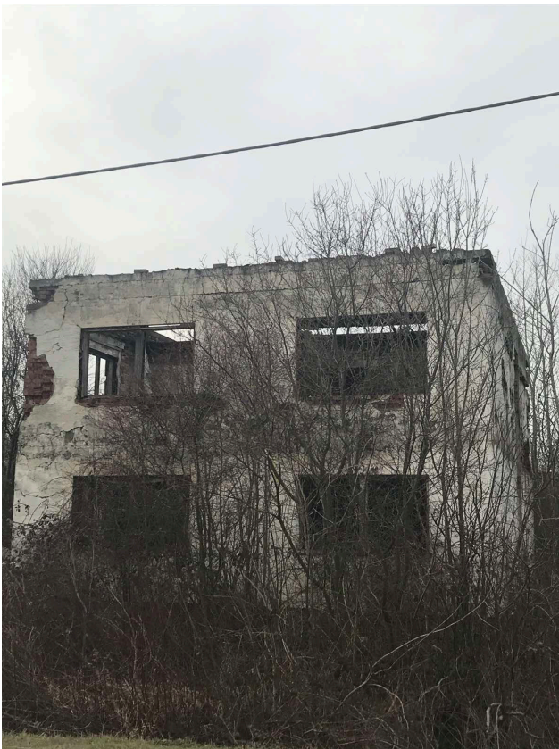
Slika 28: kuća porušena u ratu devedesetih, okolina Tuzle
