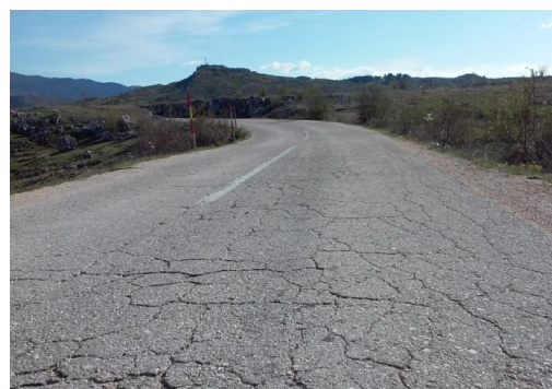
Слика 3.2. – Мрежасте пукотине на коловозном зазору које условљавају смањење квалитета возње, пут R432 у БиХ (Гацко - државна граница са Црном Гором)
