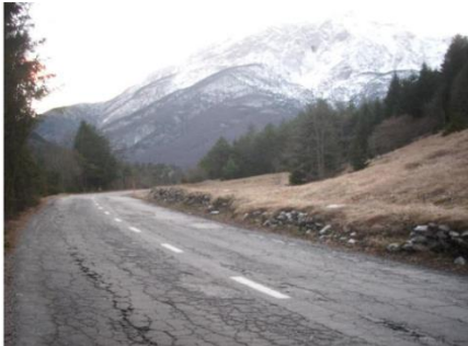
Слика 9.13. – Оштећења банкина и појаве мрежастих пукотина на путу Idrija - Idrijska Bela
