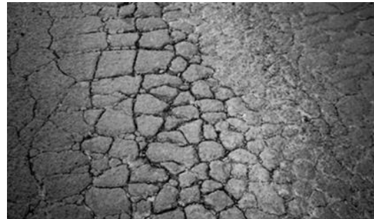
Слика 2.2. – Мрежасте пукотине
