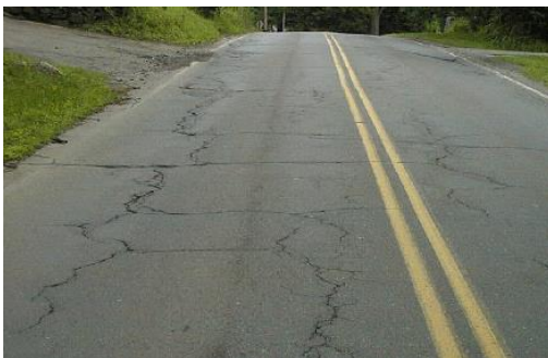
Слика 2.3. – Блоковске пукотине
