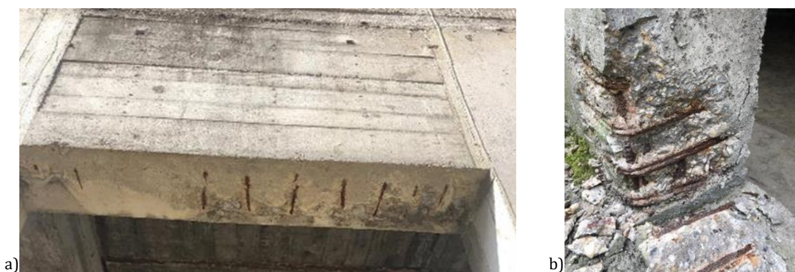
Slika IV-1. Oštećenja koja zahtevaju [42]: a) Nekonstrukcijsku sanaciju, b) Konstrukcijsku sanaciju
