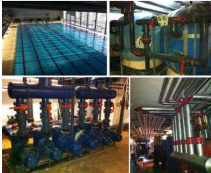
Слика 2.11. Олимпијски базен, третирање воде, пумпна станица, дистрибуциона станица (Santa Maria de Lamas) Извор: SportE 2
