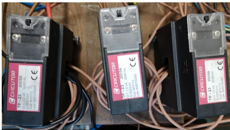
Сл. 6.7: Струјни трансформатори
