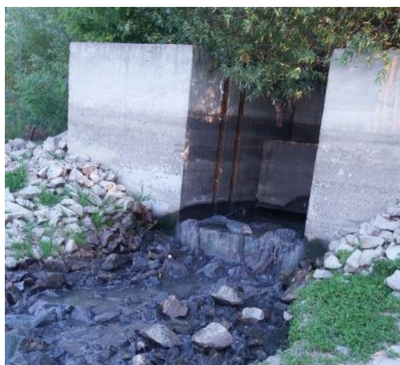
Slika 7.4. Ispust otpadne vode RO
