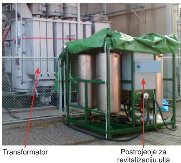
Slika 5.6. Fotografski izgled postrojenja za revitalizaciju OTU
