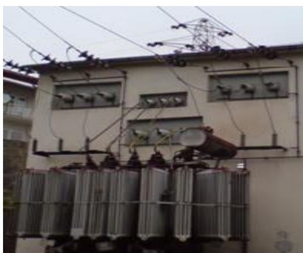
Slika 3.1. Transformator priključen na elektroenergetsku mrežu u trafostanici [2]
