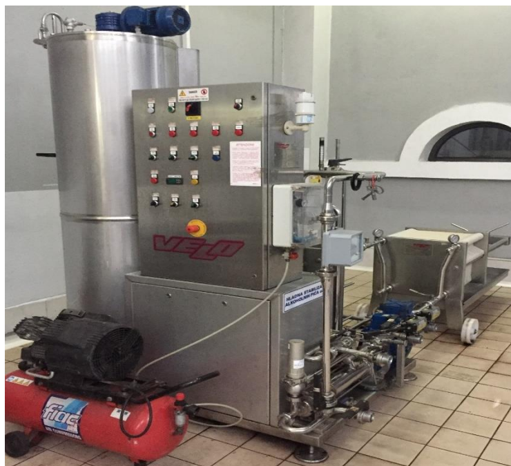
Fotografija 29. Rashladno postrojenje za stabilizaciju destilata
