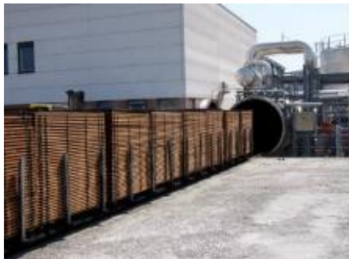
Slika 3. Komora za vlažnu fazu termičke modifikacije izrađena od nerđajućeg čelika (Plato international)
