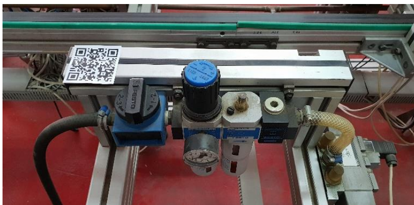
Slika 4-8 Filter vazduha na liniji za montažu vodenih pumpi sa markerom u vidu QR koda
