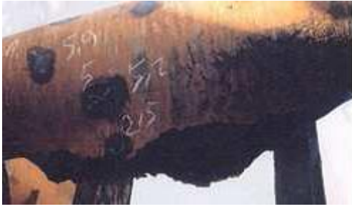
Slika 13. Cev od 8" sa pukotinom od 800 x 200 mm [35]
