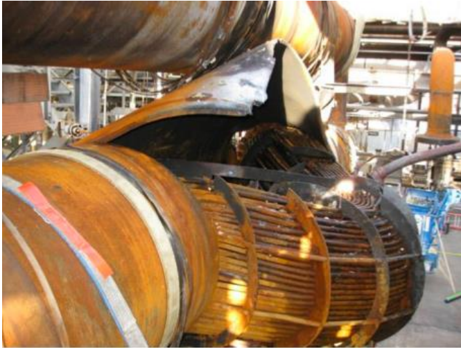
Slika 16. Ruptura na razmenjivaču koja je izazvala eksploziju [41]
