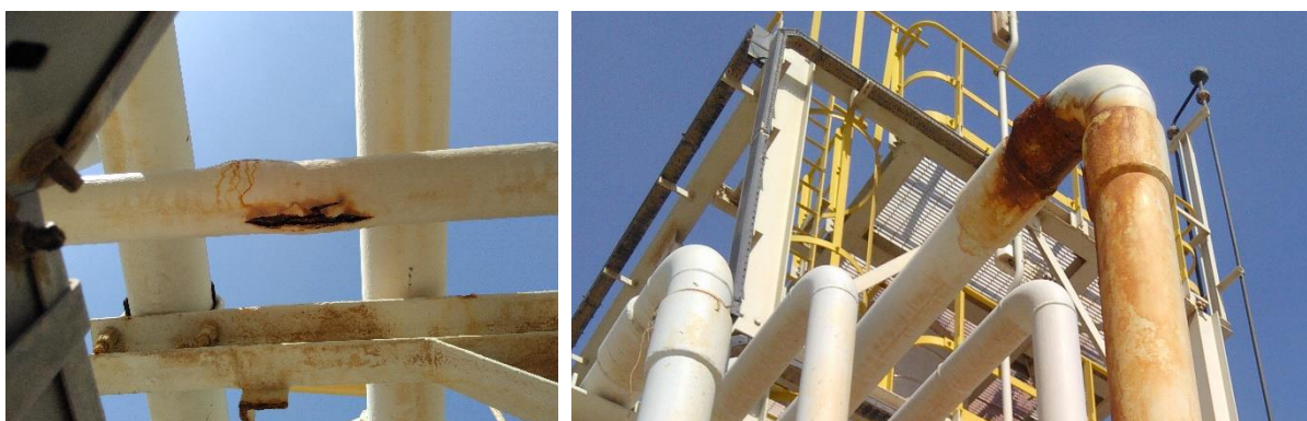
Slika 26. Primeri oštećenja cevovoda, levo ekstenzivna korozija i moguća prslina, desno ekstenzivna korozija i moguće curenje
