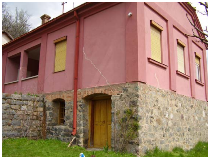
Slika 4-31. Stambeni objekat na kome je praćen pomeraj pukotina [106]
