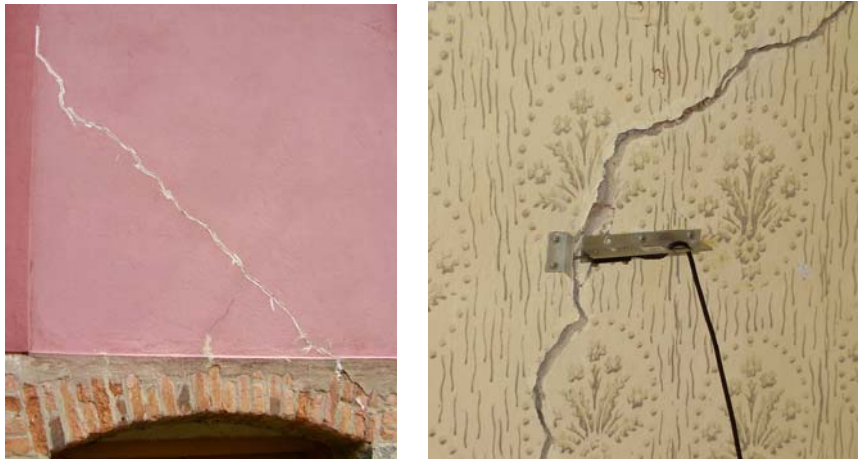
Slika 4-34. Pukotina 2 sa spoljne strane kuće (levo) i položaj senzora na pukotini 2 (desno)
