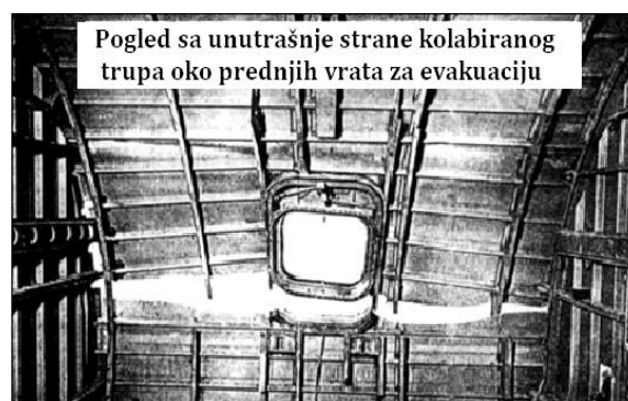
Slika 39. Oštećenje trupa na ispitivanom modelu Comet G-ALYU [66]
