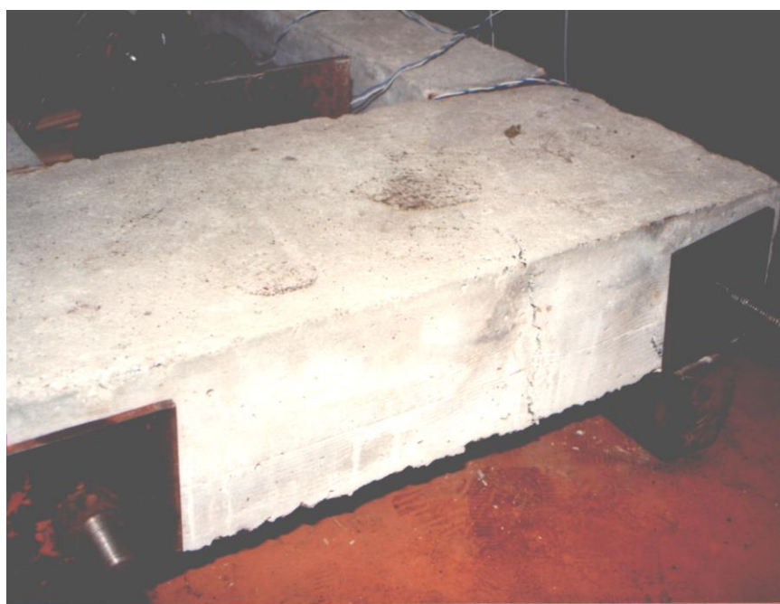
Слика 9.10. Приказ пукотине на траверзи вишеделне носеће структуре
