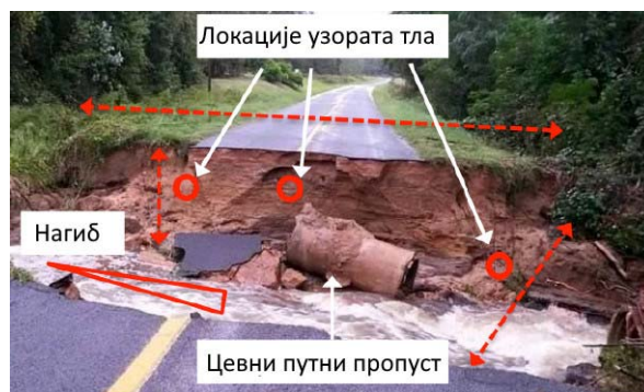
Слика 1-3: Оштећење саобраћајнице у профилу путног пропуста после појаве преливања воде [15]
