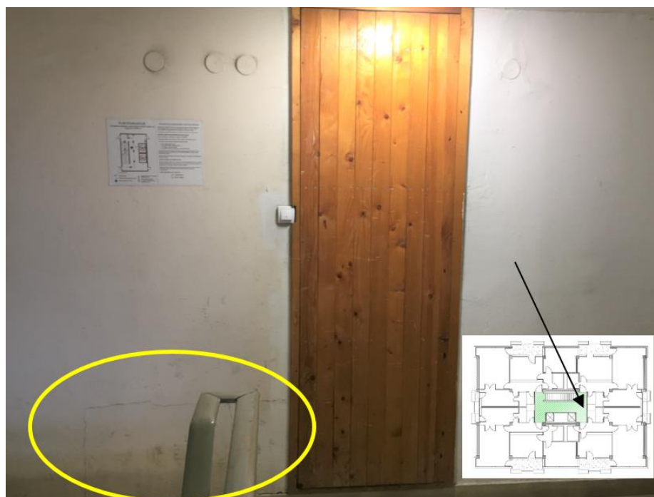
Sl. 5.50 – Pukotina širine 0,4-0,75 mm ns gipsanom zidu na I spratu i drvena vrata koja odvajaju instalacioni šahit od hodnika
