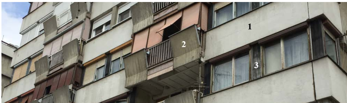
Sl. 4.31 - Detalji duže fasade stambene kule NF-26: 1– lođa (montažni betonski panel), 2- balkon (montažna betonska puna ograda) i 3 – međuprozorski stubić
