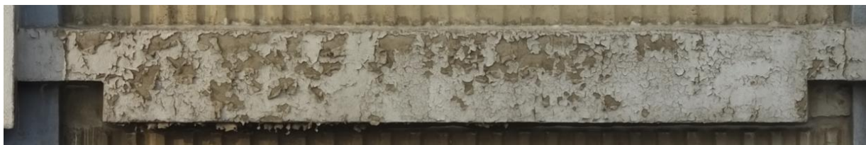
Sl. 5.42 – Oštećenja identifikovana na ivičnim gredama na južnoj fasadi: mrlje od prljavštine, ljuskanje završnog premaza, mali zaštitni sloj betona, pucanje, odvajanje i otpadanje betona usled korozije armature
