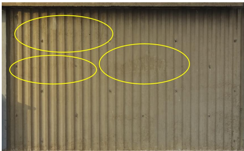
Sl. 5.27 – Lokalne promene boje zidova usled nečistoće oplatnih ravni i izbora neadekvatnog sredstva za sprečavanje/smanjenje athezije između betona i oplatne ravni (segment zida Z B-C/1 na XIII spratu )
