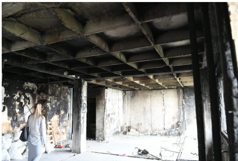
Sl. 5.72 – Noseći elementi IMS konstrukcije zgrade u ulici Milutina Milankovića 110 oštećeni u požaru koji se dogodio 2020. godine (Milovanović, 2020)
