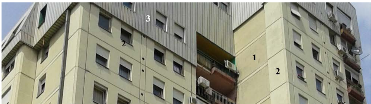
Sl. 4.40 – Detalji fasade stambene kule PB-22: montažno AB platno (1), betonski paneli (2) i zidovi od gas-betonskih blokova obloženi alu-limom (3)
