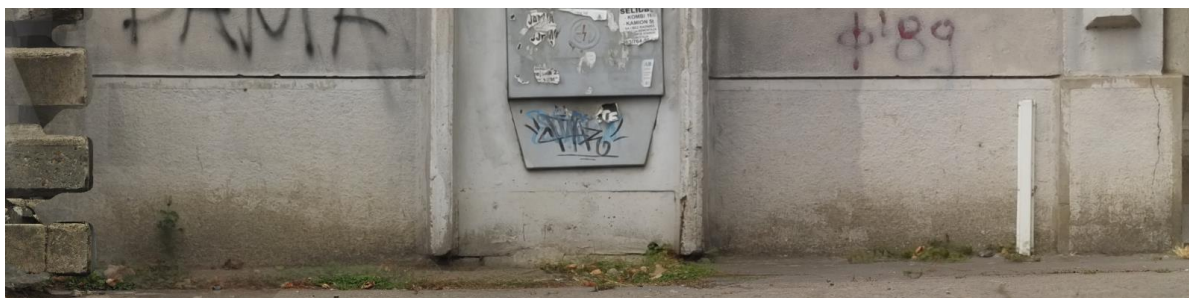
Sl. 5.19 – Biološka korozija identifikovana u zonama kontakta zidova sa tlom (segment zida Z D-E/1 u suterenu)
