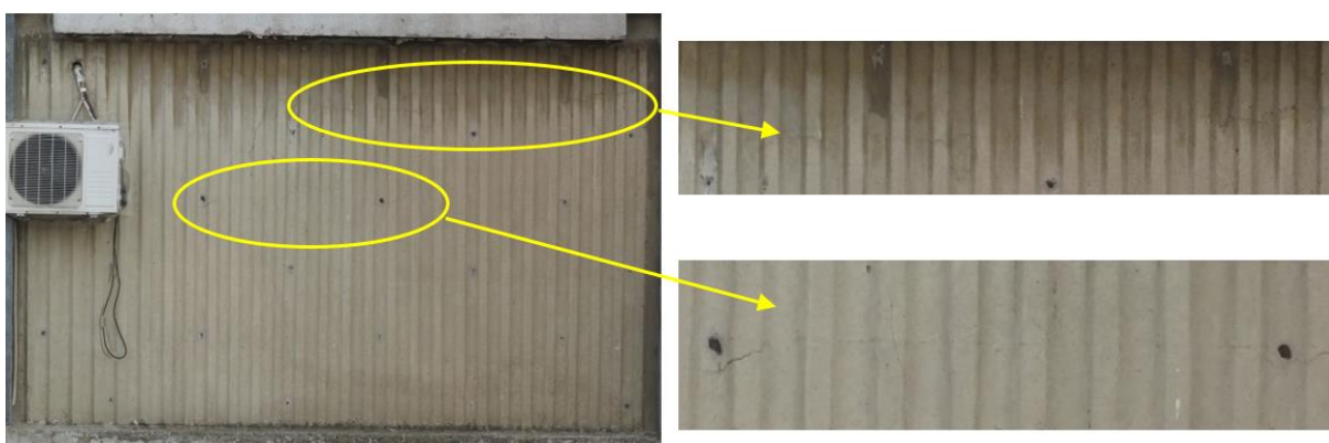
Sl. 5.26 – Neadekvatno povezani slojevi betona identifikovani na AB zidovima severne fasade; horizontalna pukotina identifikovana na segmentu zida Z_{D-E/6} na IX spratu na mestu ovog defekta
