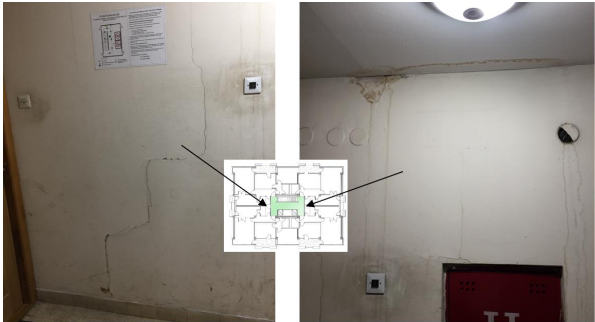
Sl. 5.51 – Pukotine širine 0,5-1,25mm i tragovi curenja vode na gipsanom zidu na VIII spratu
