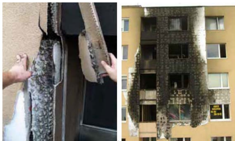
Sl. 3.38 – Posledice požara na stambenoj zgradi u gradu Miškolc, u Mađarskoj (White & Delichatsios, 2014)
