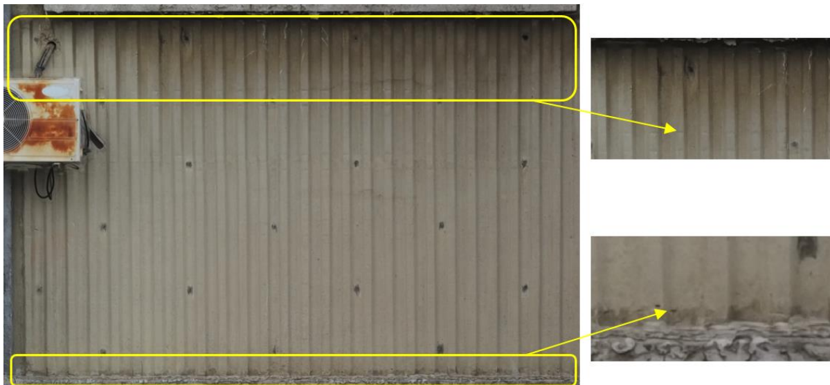
Sl. 5.15 – Mrlje od vlage identifikovane u gornjim i donjim zonama zidova, na spoju sa horizontalnim ivičnim nosačima (segment zida Z D-E/1 na IX spratu)
