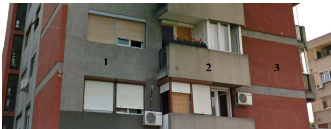
Sl. 4.50 – Detalji kraće fasade stambene kule Fr-21: zidovi od giter opeke, obostrano malterisani (1), montažni betonski parapetni elementi(2) i ventilisani AB zidovi sa završnom oblogom od malterisane giter opeke (3)
