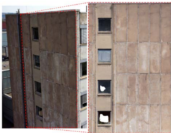
Sl. 3.11 - Oštećena zapadna fasada zgrade (levo) i ortofoto mozaik visoke rezolucije (desno) (Hallermann et al., 2015)
