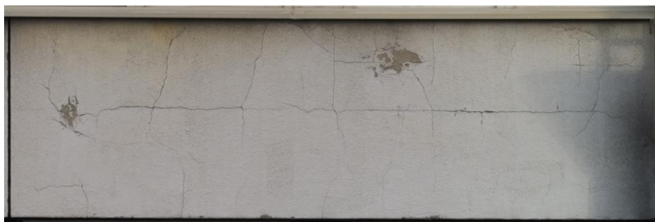
Sl. 5.31 – Izgled karakterističnih prslina i pukotina identifikovanih na parapetnim elementima dužih fasada (parapet P_{5-6/A,V} )
