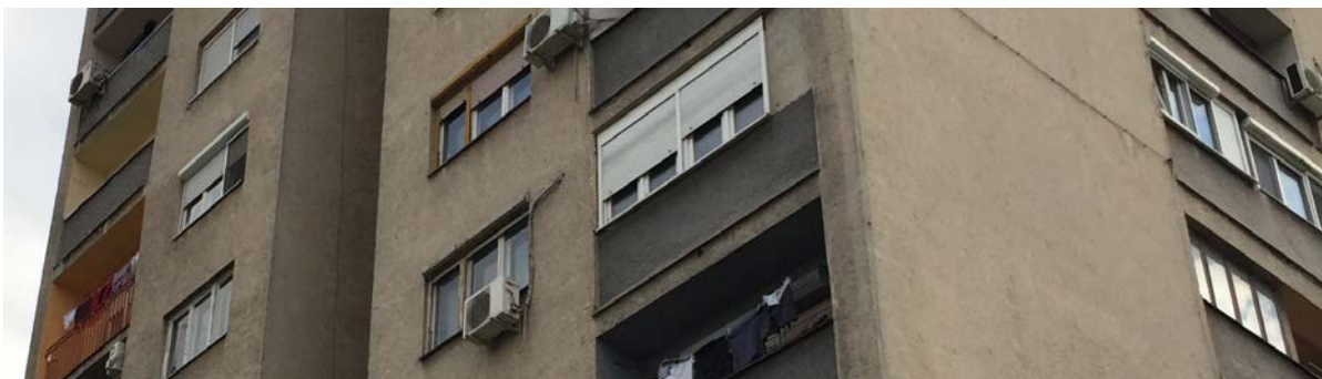
Sl. 4.18 – Detalji fasade stambene kule KM-60: spoljni zidovi od tufe blokova d=20\text{cm} sa završnom obradom od plemenitog maltera („teranova“)
