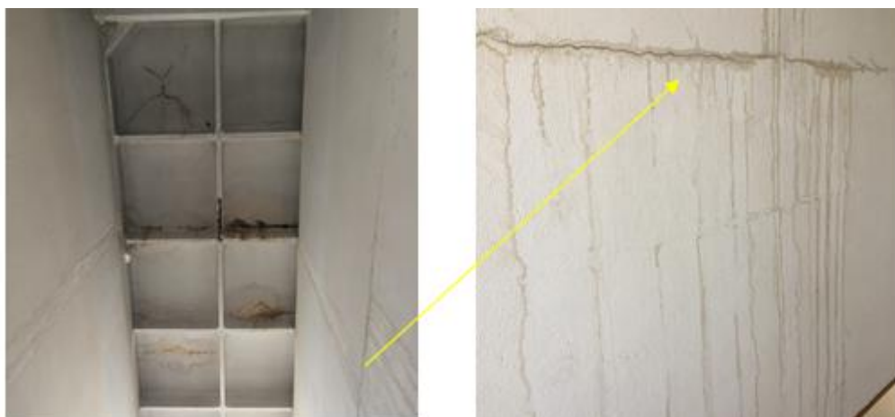
Sl. 5.53 – Oštećenja na elementima poslednje etaže, iznad stepenišnog prostora: (a) pucanje, odvajanje i otpadanje površinskog sloja betona usled korozije armature i tragovi curenja vode na kasetiranoj tavanici; (b) pukotine i tragovi curenja na zidu
