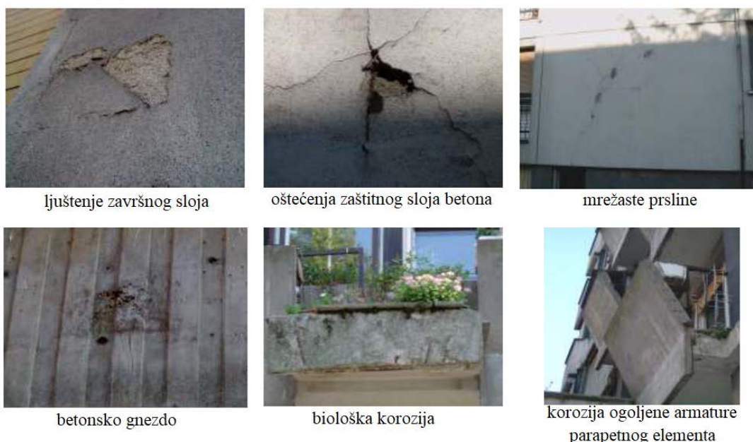
Sl. 3.23 - Primeri identifikovanih defekata i oštećenja betonskih fasada montažnih i polumontažnih zgrada izgrađenih u istraživanom periodu u Novom Sadu (Laban, 2012)
