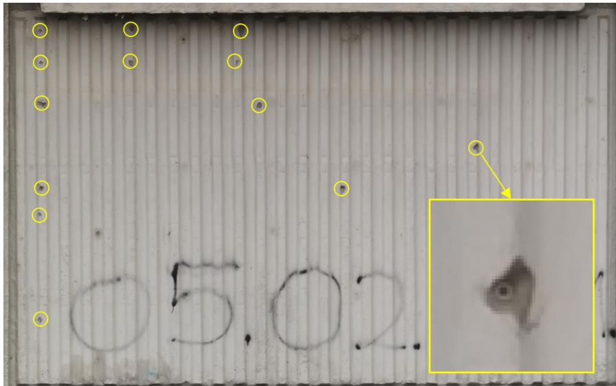
Sl. 5.22 – Lokalna mehanička oštećenja betona (segment zida Z B-C/1 u prizemlju)
