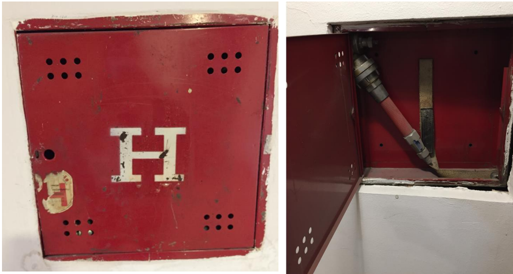
Sl. 5.79 – Hidrantski ormari sa nepotpunom opremom
