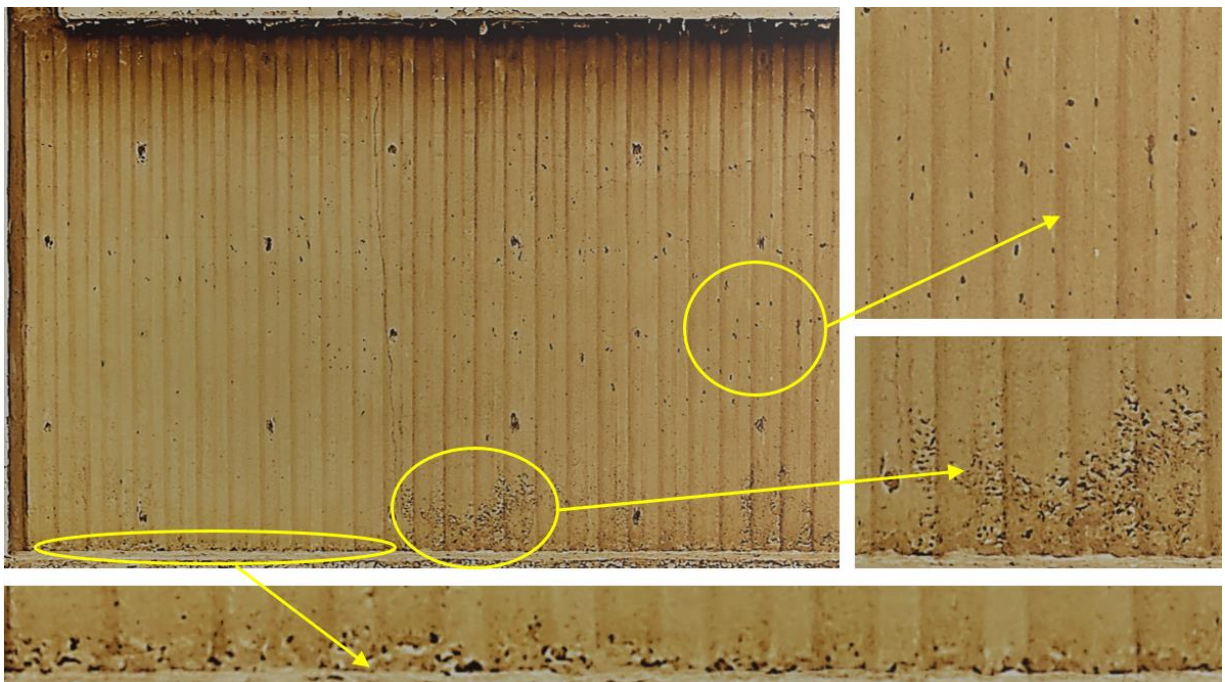
Sl. 5.23 – Defekt rupičaste površine identifikovan na celoj površini zidova i lokalno nedovoljno zbijen beton u donjim zonama zidova (segment zida Z D-E/1 na X spratu)
