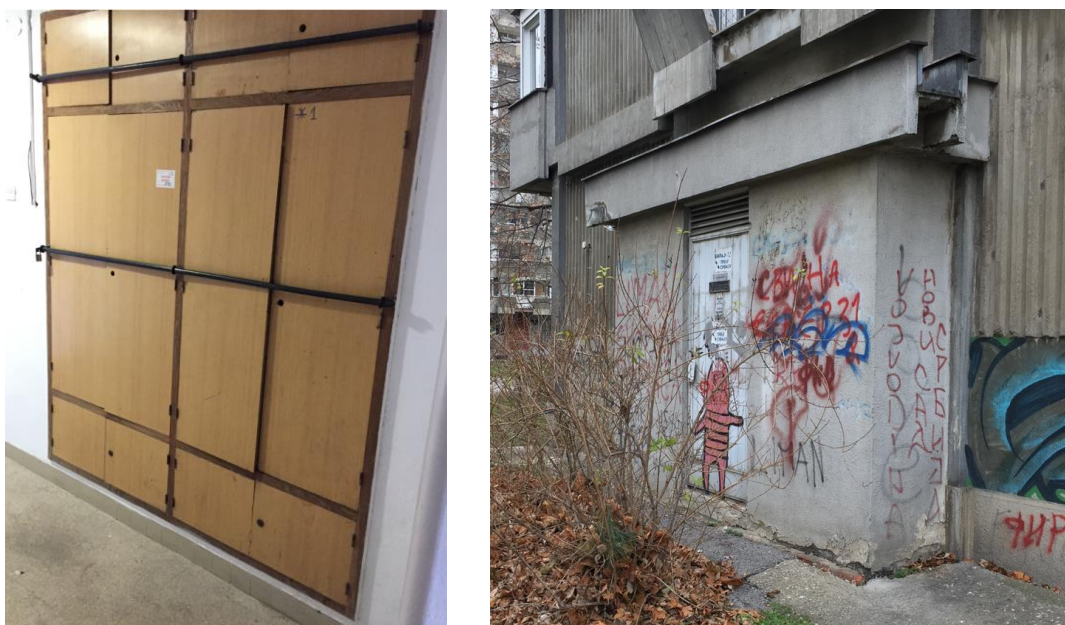
Sl. 5.78 – Glavni razvodni ormar u ulaznom holu i prostorija trafostanice u prizemlju zgrade
