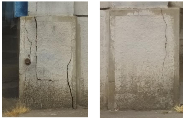
Sl. 5.46 – Pucanje i odvajanje sokle od veštačkog kamena u zoni stubova na kontaktu zgrade sa tlom na južnoj fasadi
