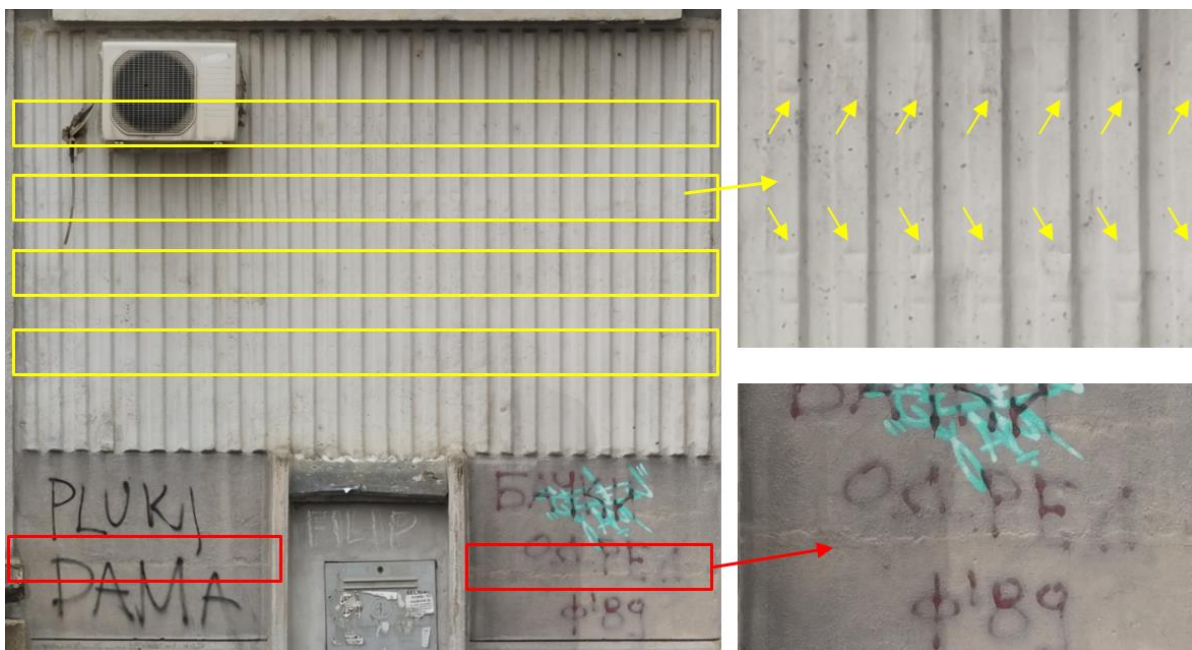
Sl. 5.25 – Geometrijska imperfekcija identifikovana na AB zidovima južne fasade (obeležena žutom bojom) i neadekvatno izveden prekid i nastavak betoniranja segmenata zidova u suterenu i prizemlju (obeleženo crvenom bojom)
