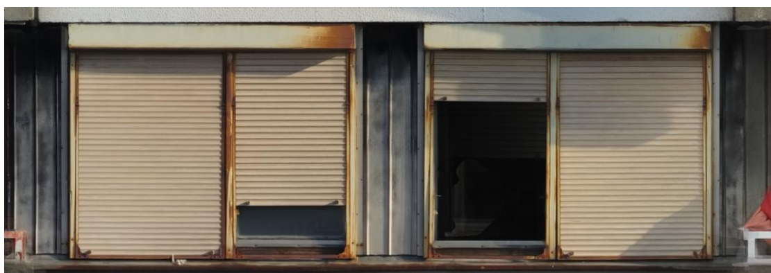
Sl. 5.48 – Dotrajala stolarija i međuprozorski stubići sa azbestnim pločama
