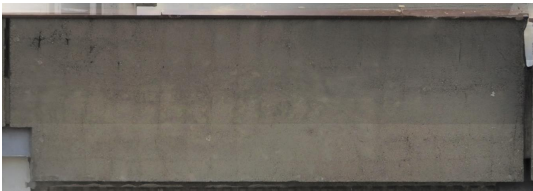
Sl. 5.47 – Lokalno nedovoljno zbijen beton i mali zaštitni sloja betona na elementima krovne atike
