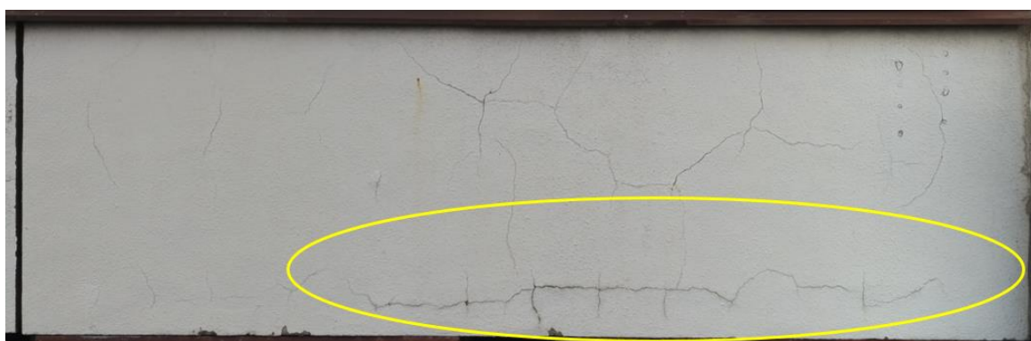
Sl. 5.37 – Pukotine koje su se preslikale sa betona na malter (parapet P_{5-6/F,XIII} na zapadnoj fasadi)
