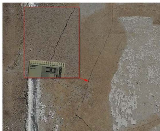
Sl. 3.12 – Jasno vidljive pukotine širine 0,5 mm detektovane sa 7,5 m udaljenosti od površine zgrade (Hallermann et al., 2015)
