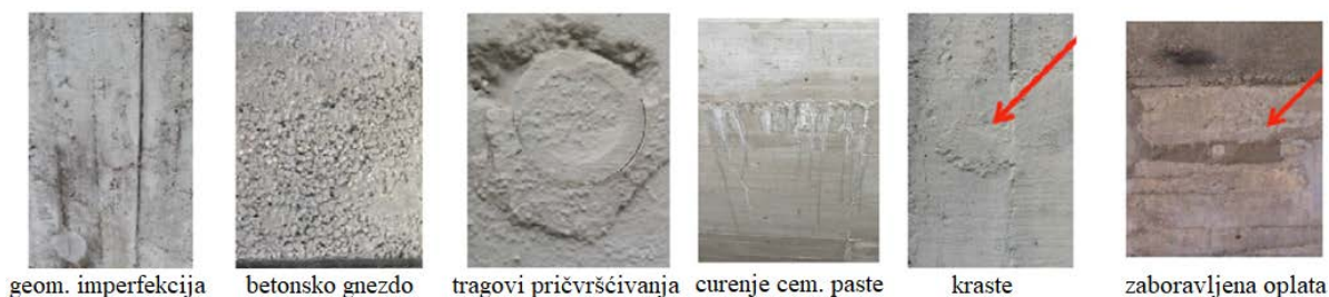
Sl. 3.22 - Geometrijska oštećenja betonskih fasada (Serralheiro et al., 2017)
