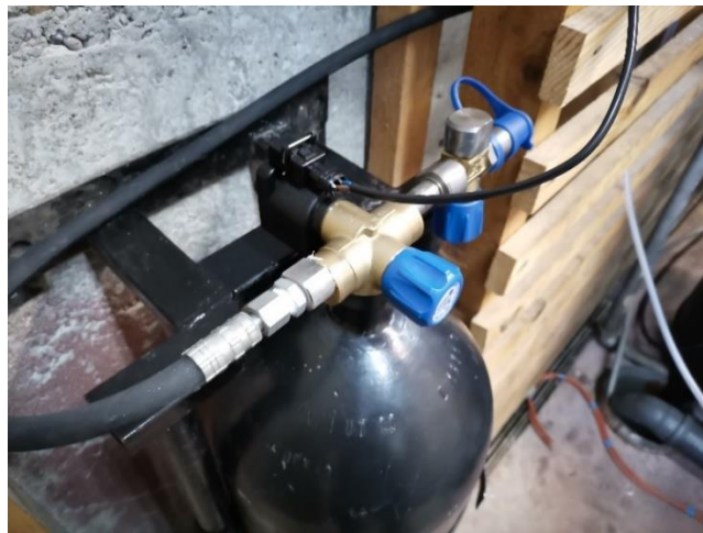
Слика 4.17. Електро-механички вентил за заустављање гаса
