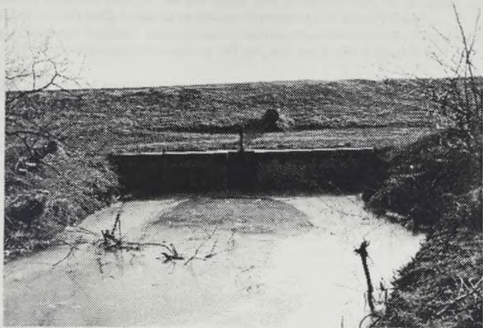
Fotografija 24: Ustava u sistemu Neuzina I, II, i III (foto: L.Lazić, januar, 1996)
